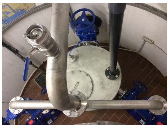
Neues Pumpwerk Jahnstraße Foto: Gemeinde Wagenfeld
