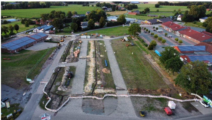
1. Bauabschnitt: Leitungsbau auf dem Marktplatzgelände und Erneuerung der Gutenbergstraße, Quelle: Gemeinde Wagenfeld
