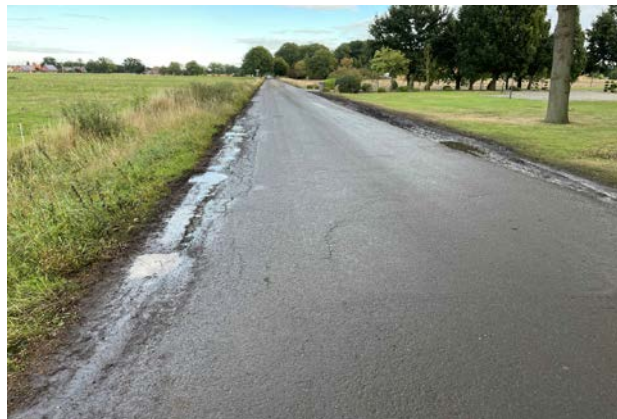
Beschädigter Seitenraum Neustädter Straße. Foto: Gemeinde Wagenfeld
