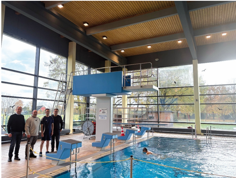
Zusammen mit Badbetriebsleiter Christian Möllers (zweiter von rechts) überzeugten sich Bürgermeister Matthias Kreye, Falko Niebuhr vom Bauamt der Gemeinde und Klimaschutzbeauftragter Sven Schröder von der effizienten neuen Beleuchtung im Hallen-Freibad Wagenfeld. Foto: Reinhard Kawemeyer
