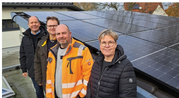
Verschaften sich bei einem Ortstermin einen Blick auf die neue PV-Anlage auf einem Teil des Daches der KiTa-Pustebblume: v.l.n.r. Bürgermeister Matthias Kreye, Klimaschutzbeauftragter Sven Schröder, Falko Niebuhr vom Bauamt der Gemeinde und die Leiterin der KiTa Pustebblume, Michaela Speckmann. Foto: Reinhard Kawemeyer.
