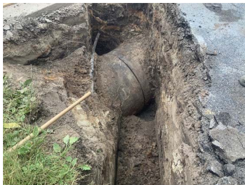
abgesackter Durchlass Renzeler Weg Foto: Gemeinde Wagenfeld)
