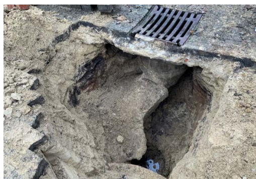
unterspülter Regenwasserschacht Eichendorfweg Foto: Gemeinde Wagenfeld
