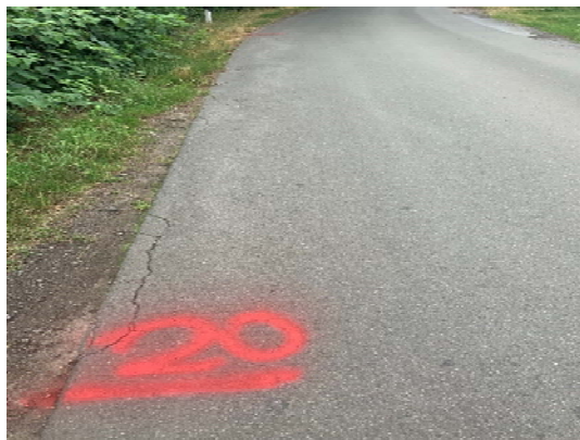
Fahrbahnschaden Renzeler Weg Foto: Gemeinde Wagenfeld
